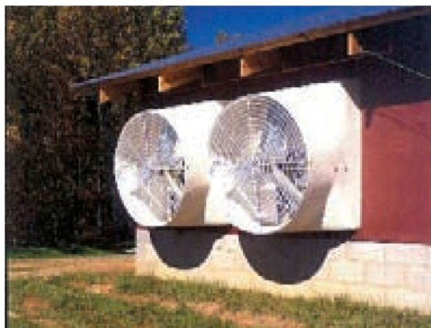
شکل ۱۸- ۴- هواکش روی دیوارهای جانبی سالن پرورش طیور
