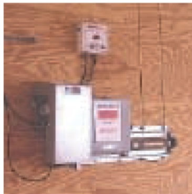
شکل ۲۳-۴- کنترل خودکار هواکش ها
